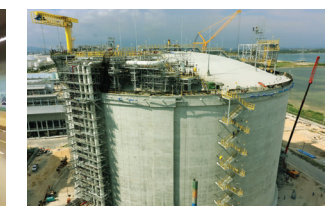
LNG Tank at Dahej Port
